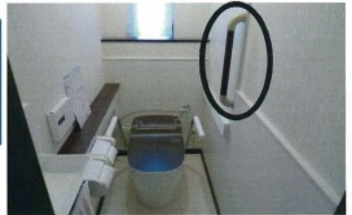
トイレ設置例
